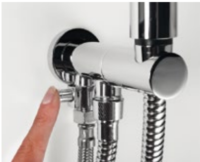
En caso de necesitar cerrar el paso de agua sólo hay que presionar la llave.
