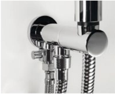
Con la llave de escuadra abierta se suministra agua al WC.
